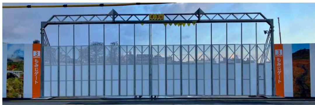
▲実際のゲート設置状況（もみじゲート）
